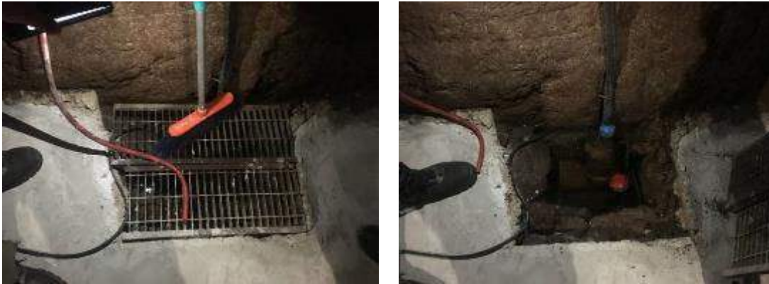
Foto nn. 1-2. Presenza della falda superficiale nel seminterrato dell'abitazione privata.
