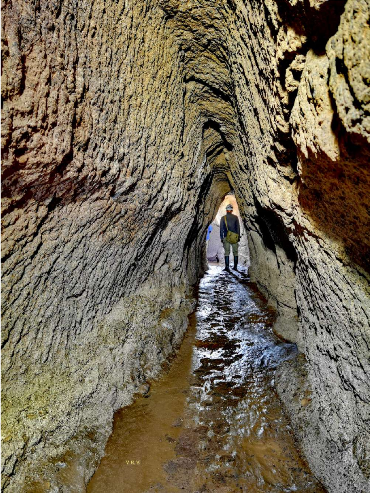
FIG.16 galleria di drenaggio delle acque superficiali area VT16
